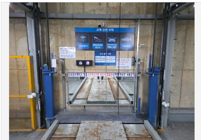
타워 내부 · 기계식 설비
