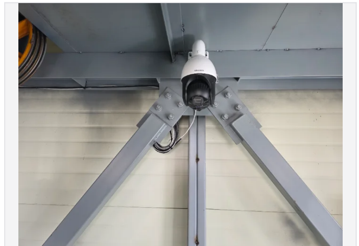
CCTV 설치 · 안전 확인용
